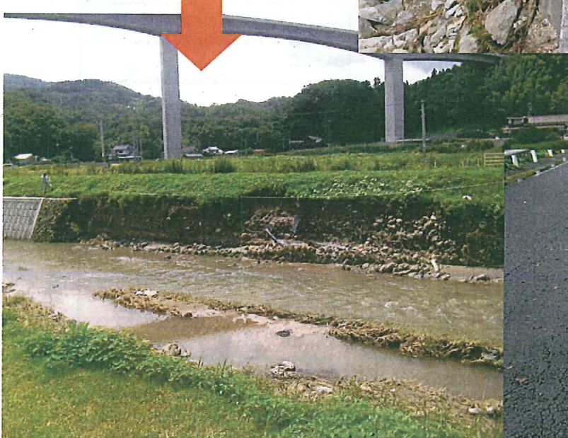
二級河川 湯里川 大田市温泉津町湯里地内 護岸崩壊
